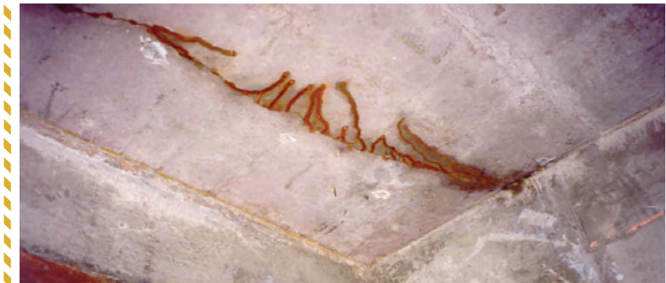
Figura 20 – Problemas na estrutura de concreto provocados por infiltrações
