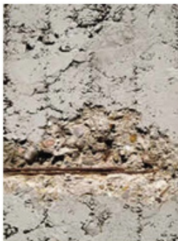
Figura 21 – Broca ou bicheira em elemento de concreto
